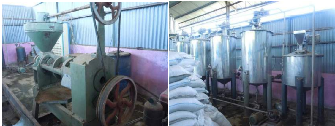
Gambar 10-3. Mesin pengolah biji nyamplung menjadi biodiesel di DME Desa Ambal, Kecamatan Petanahan, Kabupaten Kebumen, sumbangan dari Kementerian Kehutanan tahun 2009 yang sudah tidak berfungsi. ©Herti WS
