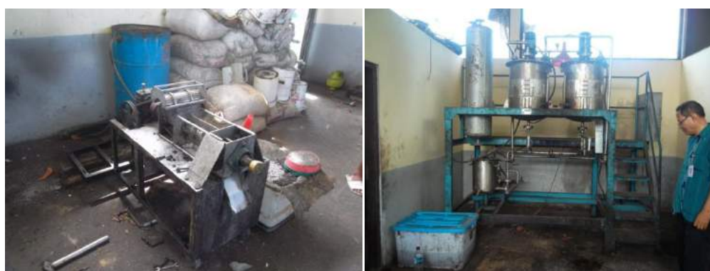
Gambar 10-2. Mesin pengolah biji nyamplung menjadi biodiesel di DME Patutrejo, Kecamatan Grabag, Kabupaten Purworejo sumbangan dari Kementerian ESDM tahun 2009 yang sudah tidak berfungsi. ©Dani Permana
